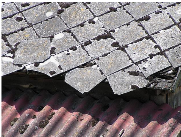
Rys. 8. Pokrycie dachowe ocenione w I stopniu pilności.
