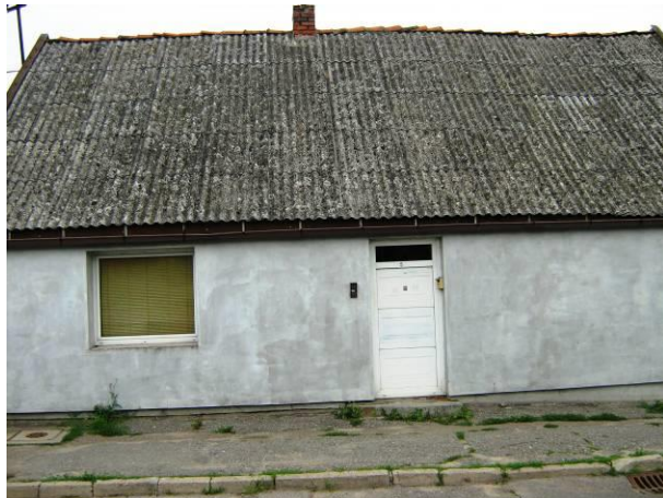
Rys. 7. Pokrycie dachowe ocenione w II stopniu pilności.
