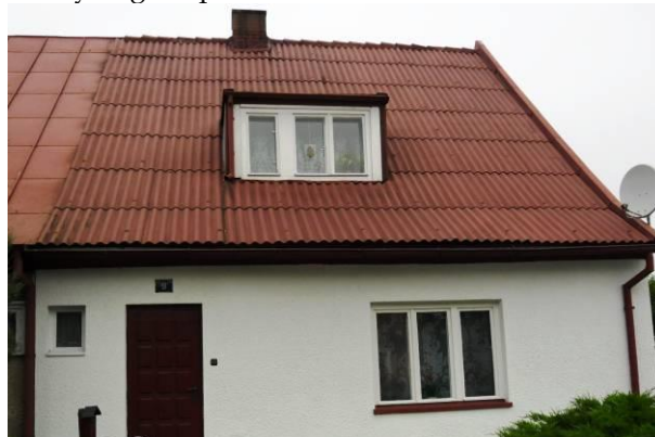
Rys. 6. Pokrycie dachowe ocenione w III stopniu pilności.
