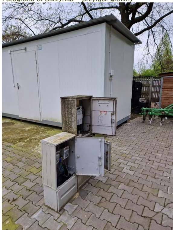
Fotografia 8. Skrzynka – przyłącz główny
