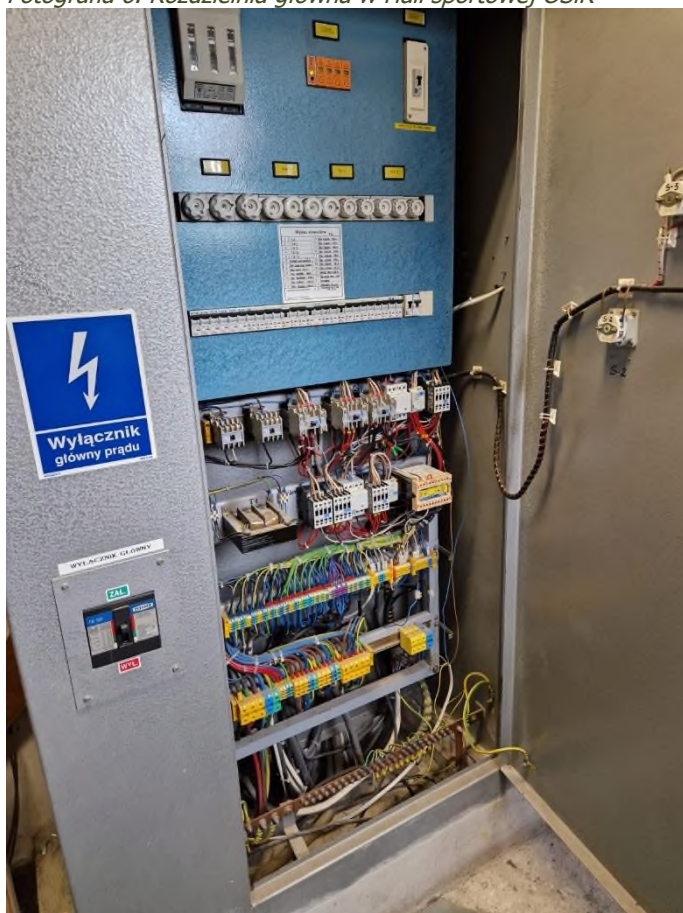
Fotografia 6. Rozdzielnia główna w Hali sportowej OSiR
