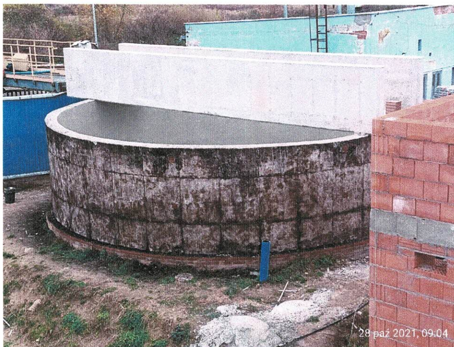
Obiekt 17 Zagęszczacz grawitacyjny - pomost
