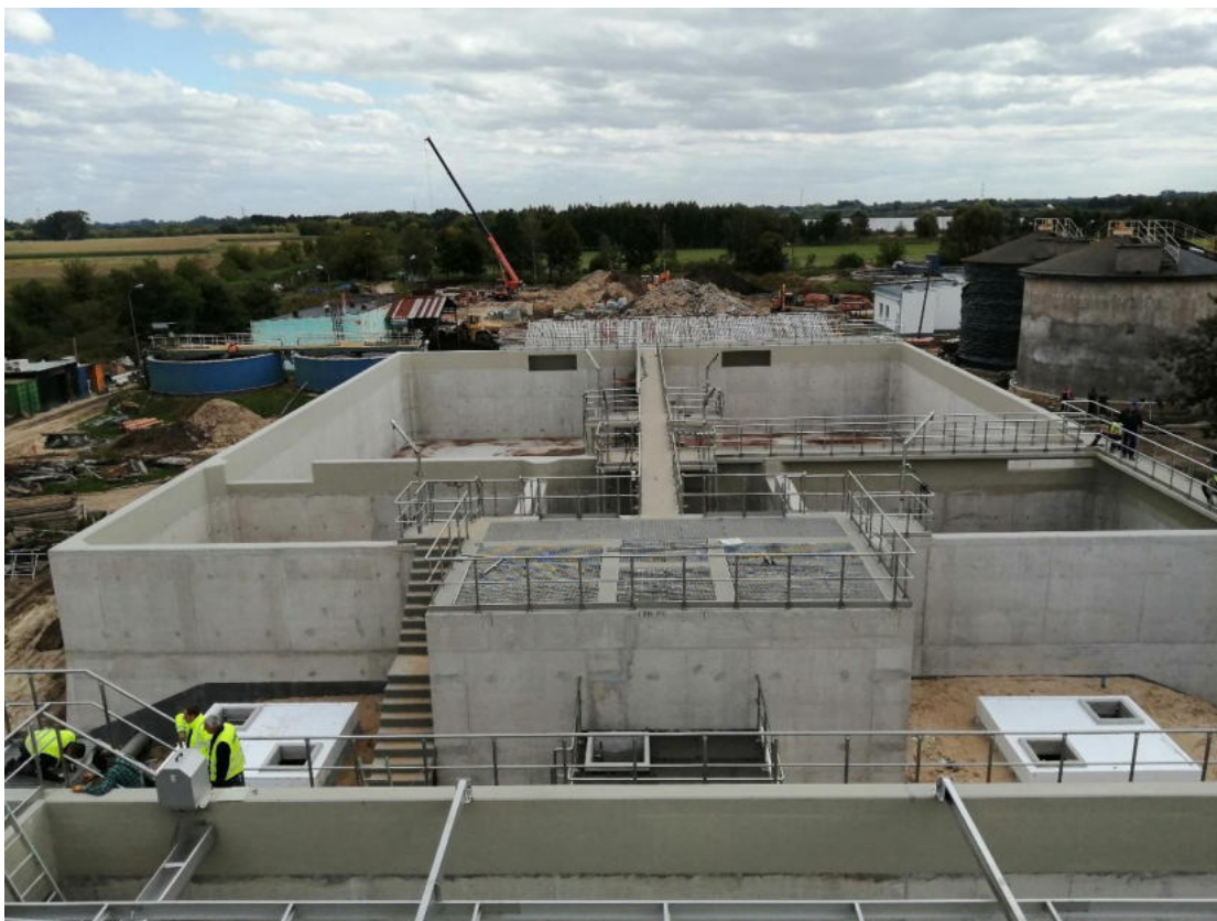
Ob. 5.1-5.2 Komory predenitryfikacji, defosfatacji i denitryfikacji
