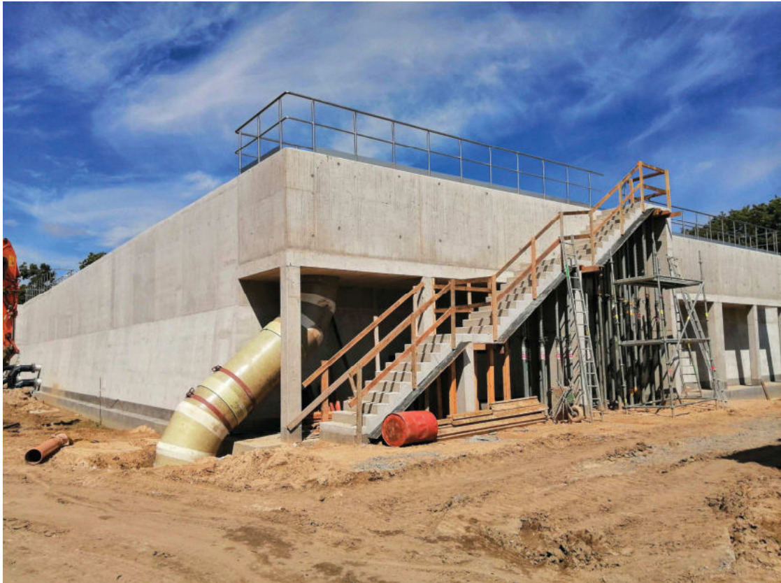
Ob. 5.1-5.2 Komory Predenitryfikacji, Defosfatacji i Denitryfikacji
