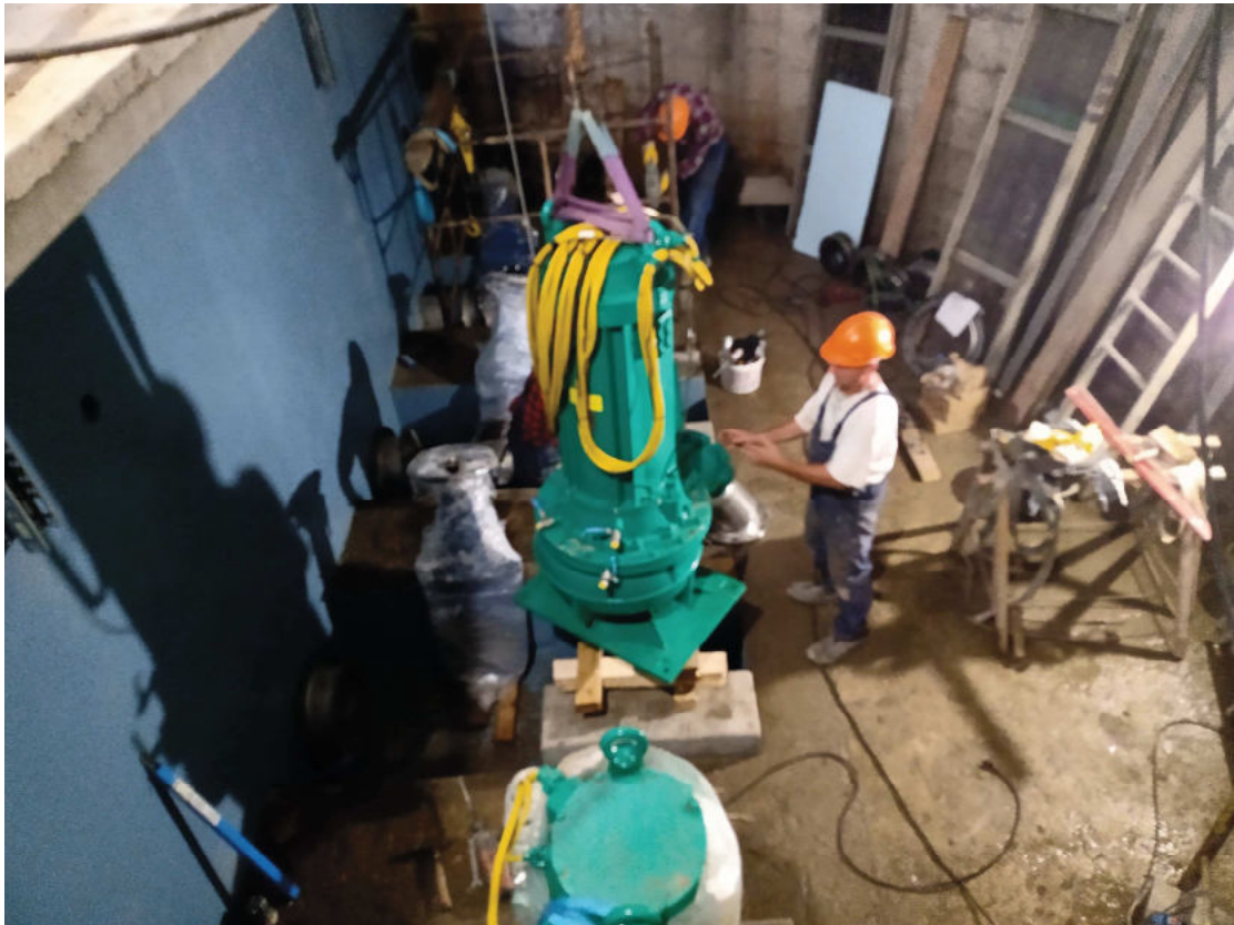
Ob. 1 i 2 Hala krat, pompownia
