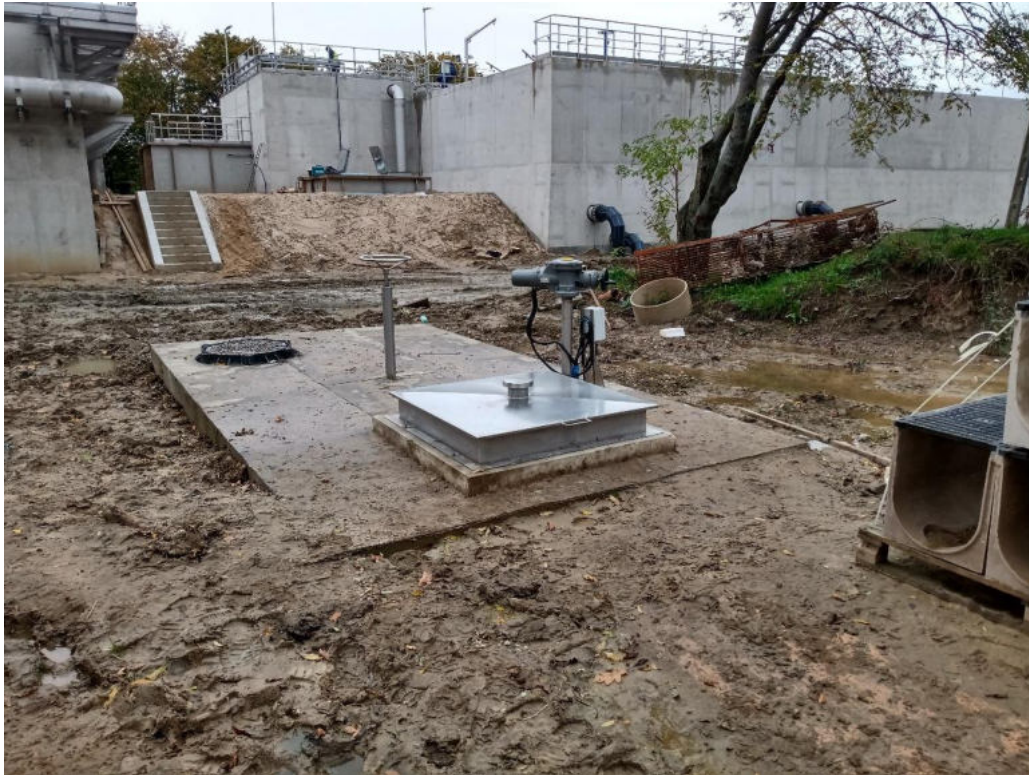
Ob. K-8 Komora wejściowa ścieków K-8
